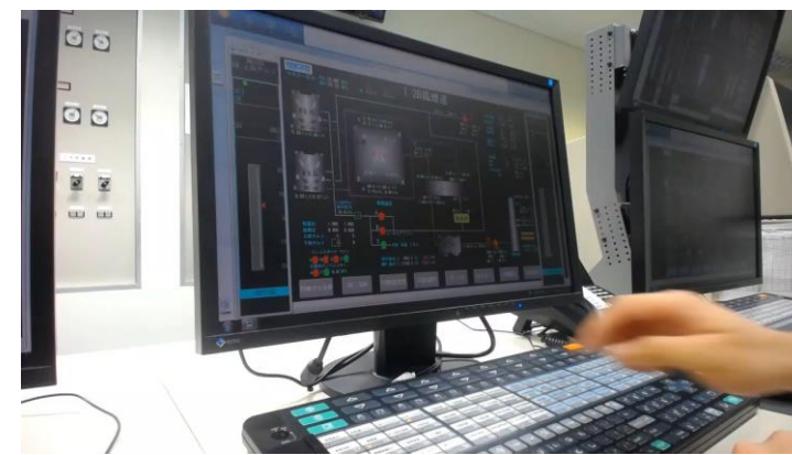
運転中央操作室
