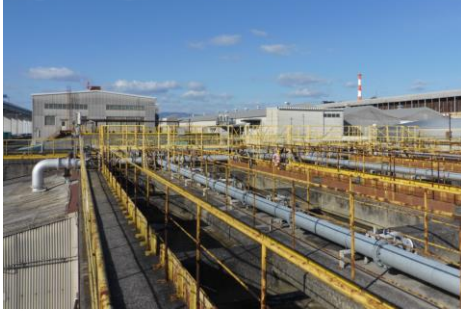
曝気槽の色異常確認
